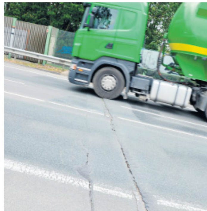
Westumgehung: Sie zeigt schon heute deutlich Spuren der Dauerbelastung und muss eine neue Decke bekommen. FOTO: A. GROBPIETSCH
